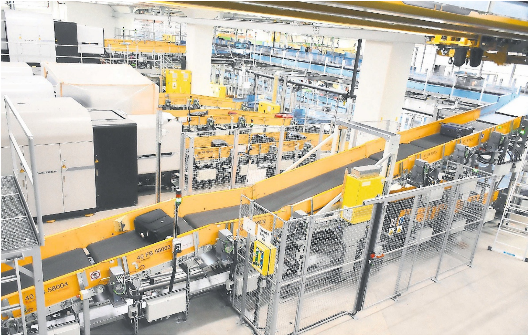
Die neue Gepäcksortieranlage hat eine Förderstrecke von 25 Kilometern. Sie ist das grösste in den vergangenen Jahren umgesetzte Bauprojekt am Flughafen.
