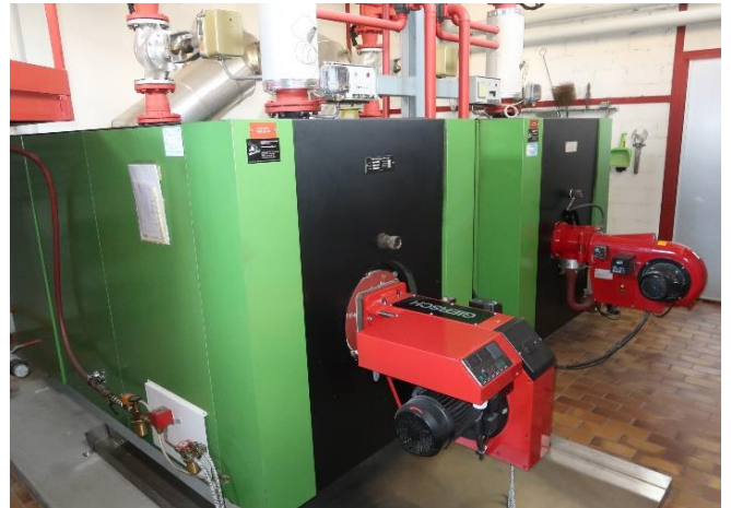
Heizanlage für die Häuser 1 - 5
